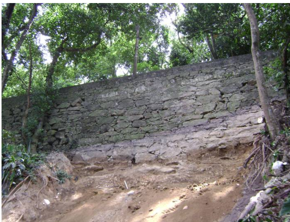
Rua Almirante Alexandrino – Santa Teresa – 21/01/2009 – Escorregamento de solo coluvionar e aterro a jusante da via
