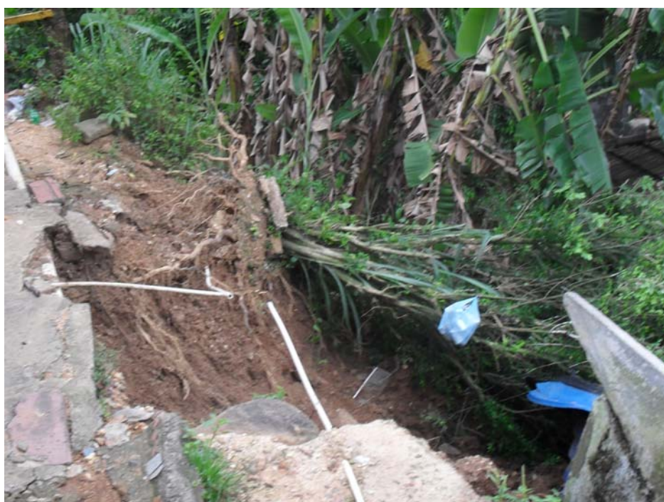
Morro do Sapê – 21/01/2009 - Escorregamento de aterro constituente de acesso dentro da Comunidade
