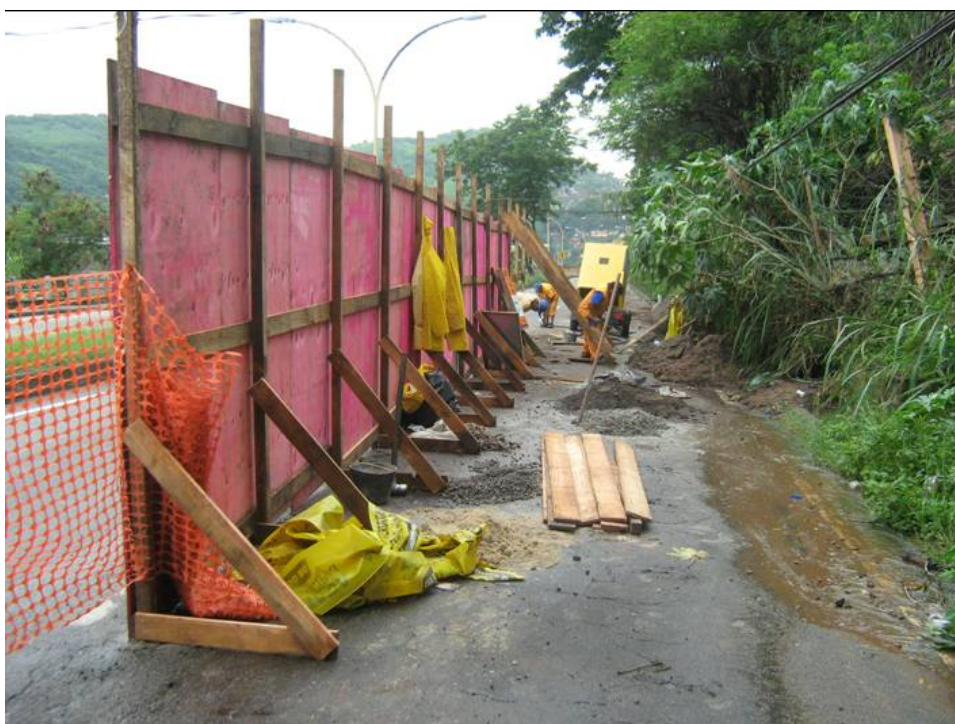
Estrada Grajaú-Jacarepaguá – 22/01/2009 - Rolamento de blocos a montante da via ficando contido pela tela metálica de impacto.
