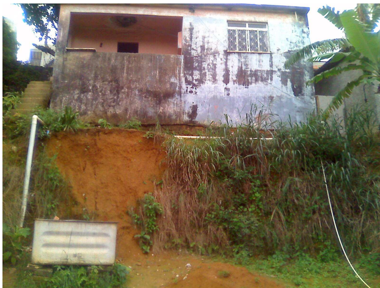
Figura 23 – Escorregamento de Solo em Talude de Corte - Anchieta
