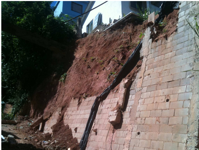
Figura 22 - Ruptura de Estrutura de Contenção - Tanque – Jacarepaguá
