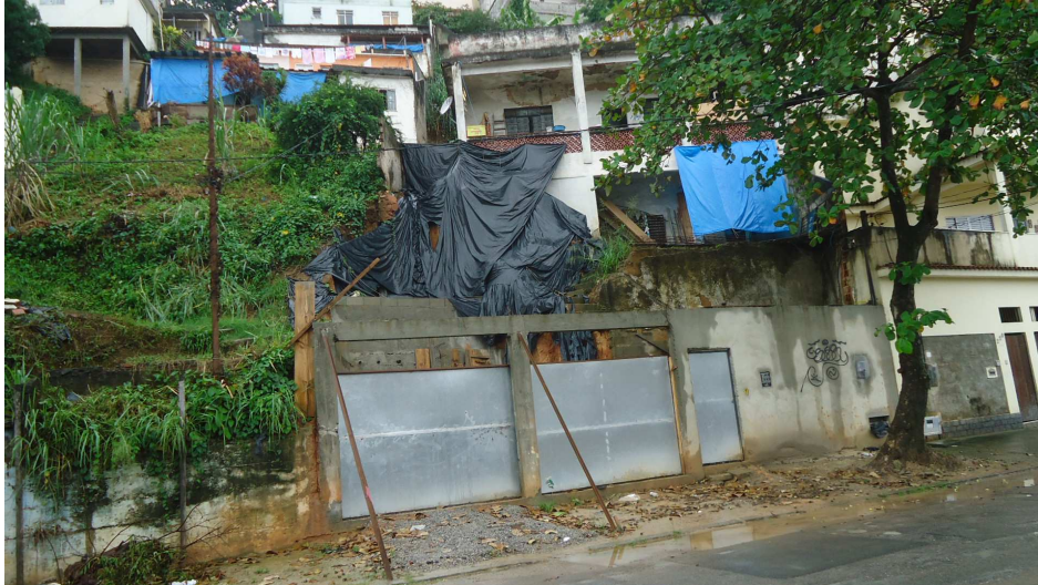
Figura 21 - Escorregamento de Solo em talude de corte – Cacuaia – Ilha do Governador
